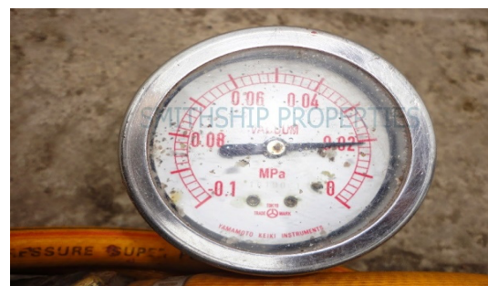
Gambar pengecekan pressure gauge di MT.ADRIA
