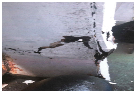
Gambar 2 frame yang rusak akibat benturan
